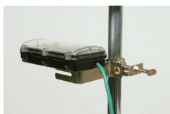
ソーラーユニット設置例
